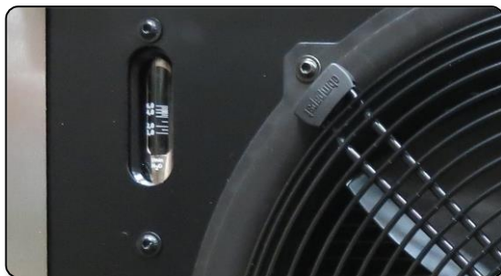
Rückkühler C3 mit Schwebekörperanzeige 1-6l/min, Magnetschalter, potentialfrei auf Klemme .17.400.051.3
